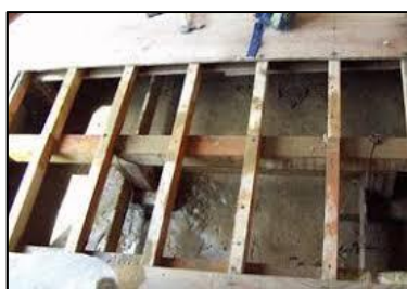
雨水が浸水した床下
