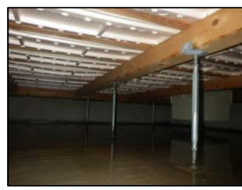
水漏れによる、床下の浸水状況
